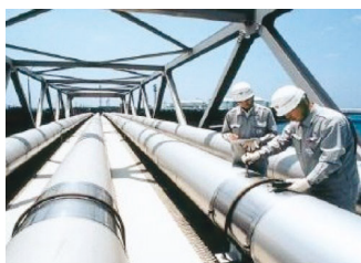
都市ガスパイプライン
