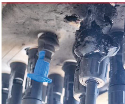
（左）DCコネクタの焼損状況
