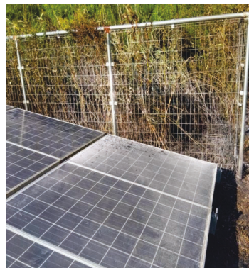
（右）焼損した太陽電池モジュール
