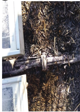
（中）焼損したPV線
