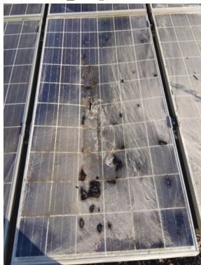
（左）焼損した太陽電池モジュール
