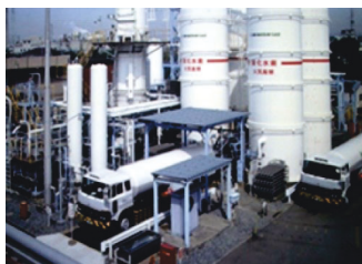
コンビナート・高圧ガス プラント
