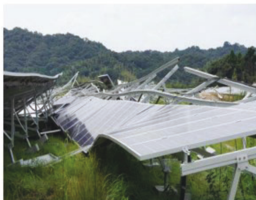
台風の影響による太陽光パネル及び架台の飛散・破損事故
